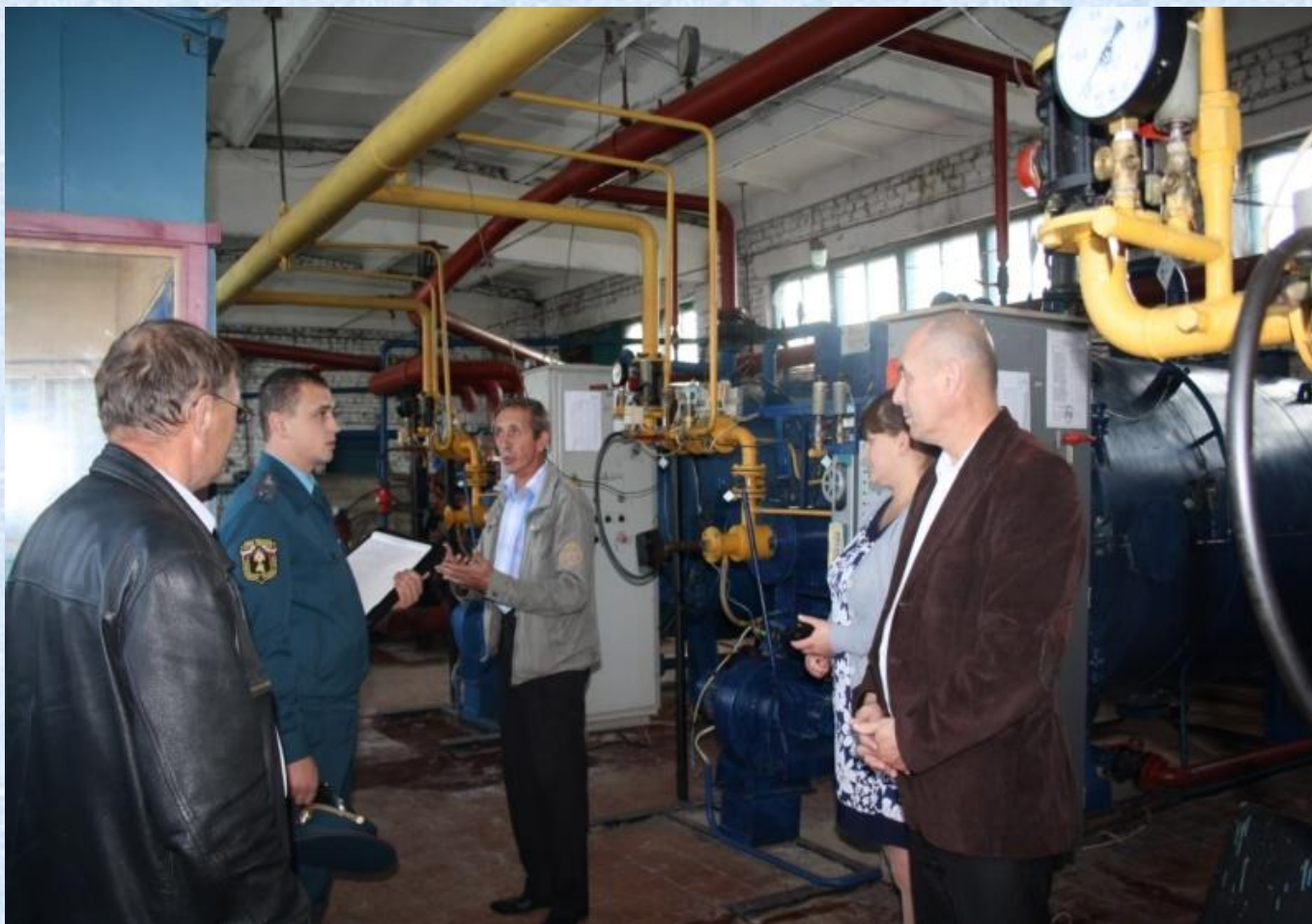
Проверка котельных к отопительному сезону 2015-2016 г.г. (16.09.2015 года)
